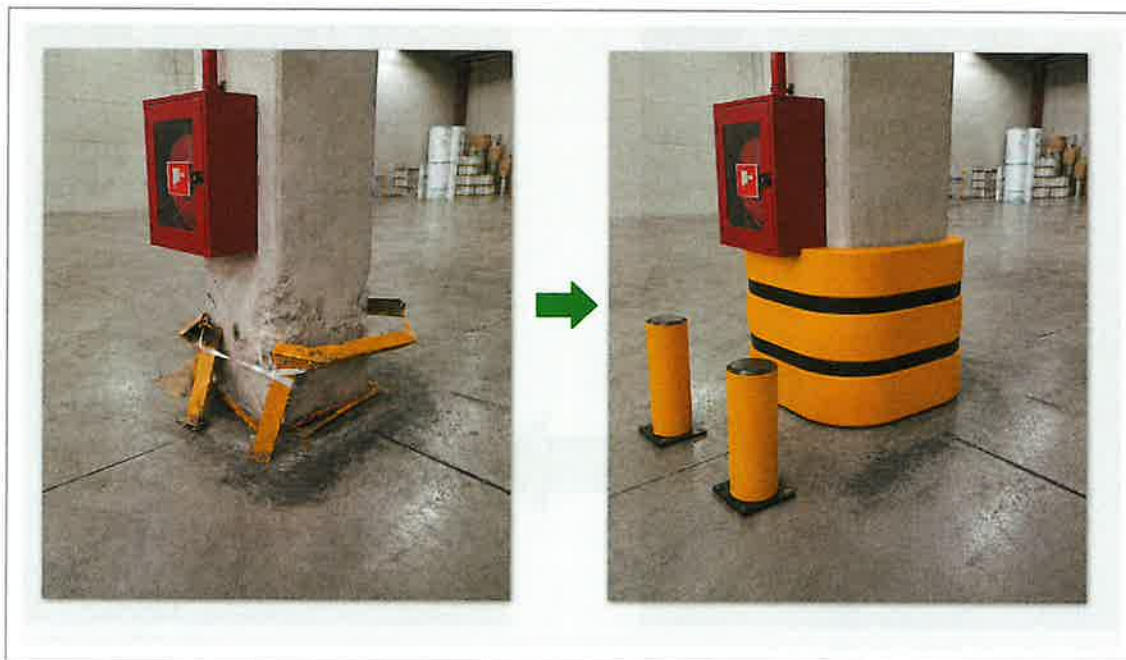
Figura 3 — Protección de pilar con BIE mediante protector envolvente y bolardos
