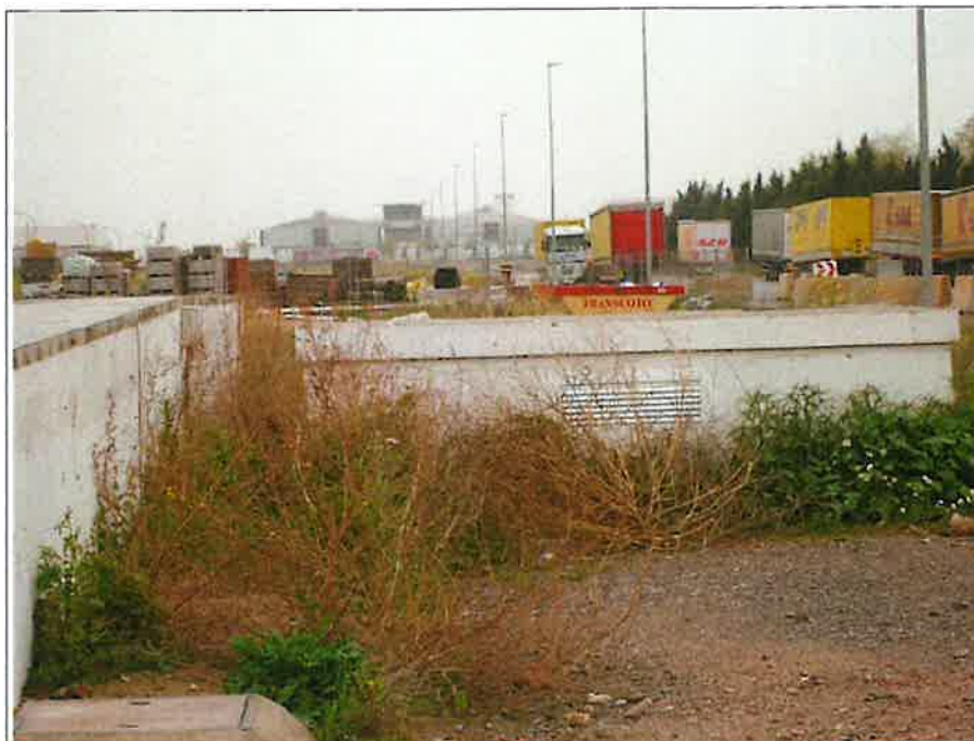
Fotografía nº 2: Arqueta de acometida
