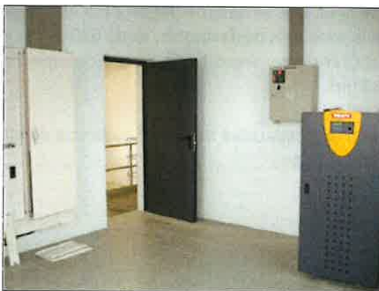
Fotografía nº 5: Sala de Control
