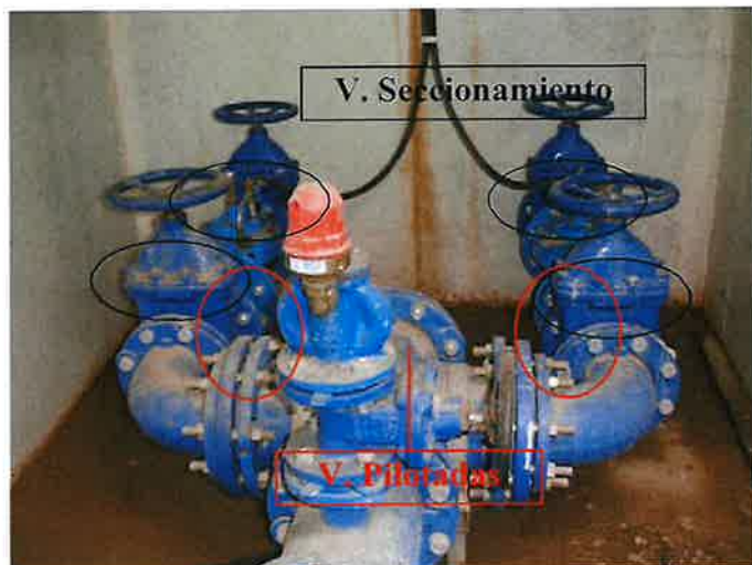
Fotografía nº 4: Válvulas arqueta de acometida
