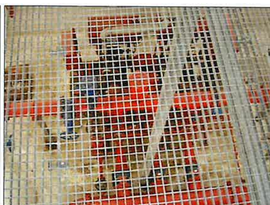
Fotografía nº 6: Sala de Bombeo
