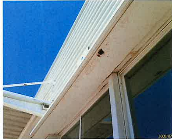
Detalle patología visera ventanas oficina
