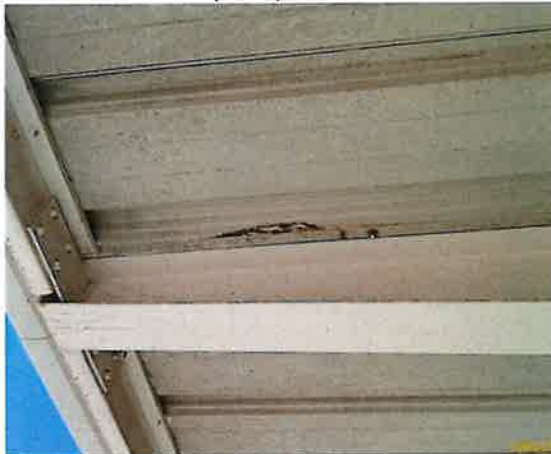
Detalle Patología marquesina entrada
