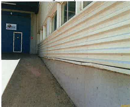
Detalle Golpes producidos en fachada de oficina
