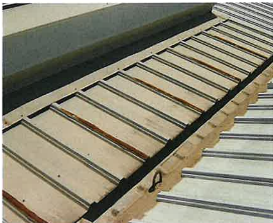
Detalle patología cubierta
