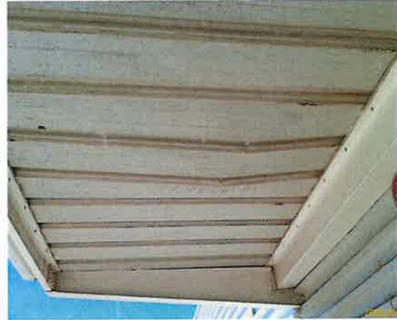
Detalle Patología marquesina entrada
