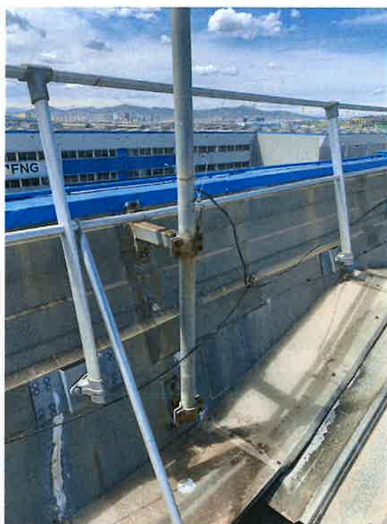
Vista sujeciones y tensor del hilo
