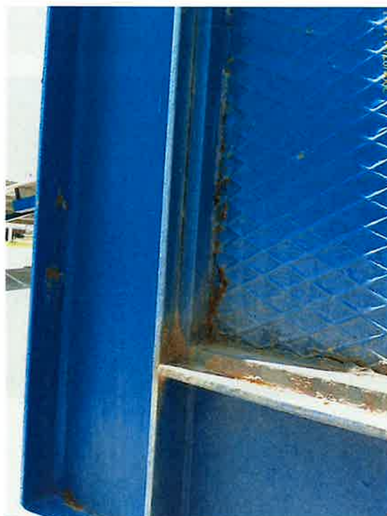
Detalle patología lucernario vertical
