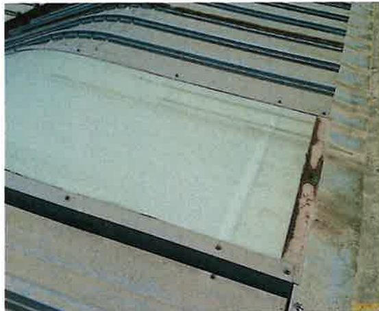
Detalle patología perfil perimetral lucernario
