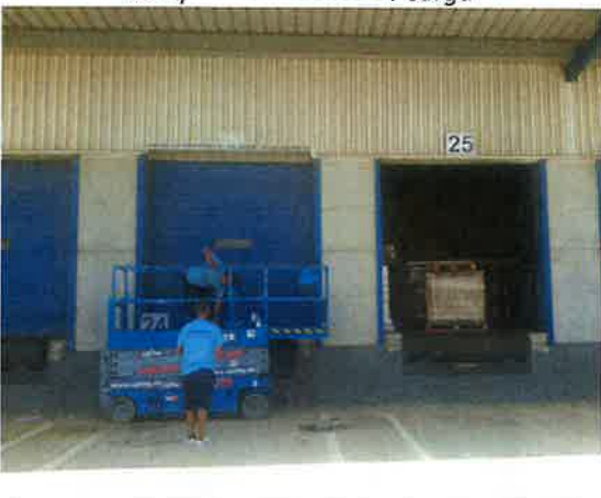
Patología Muelles de carga
