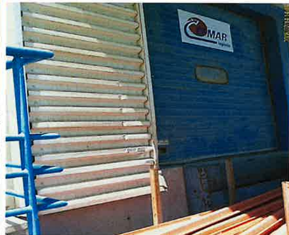
Detalle patología fachada almacén
