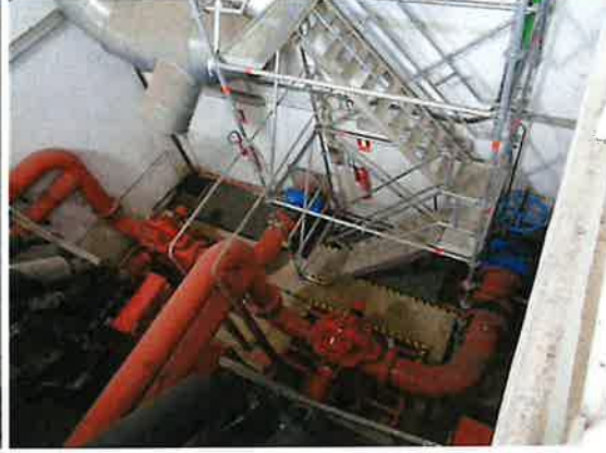
Fotografía nº 3: Sala de Bombeo
