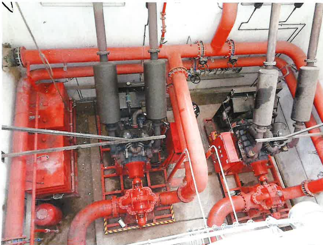
Fotografía nº 4: Grupo de bombeo contra incendios
