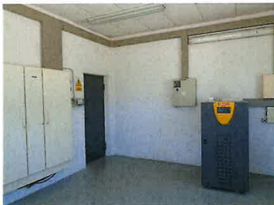
Fotografía nº 5: Sala de Control
