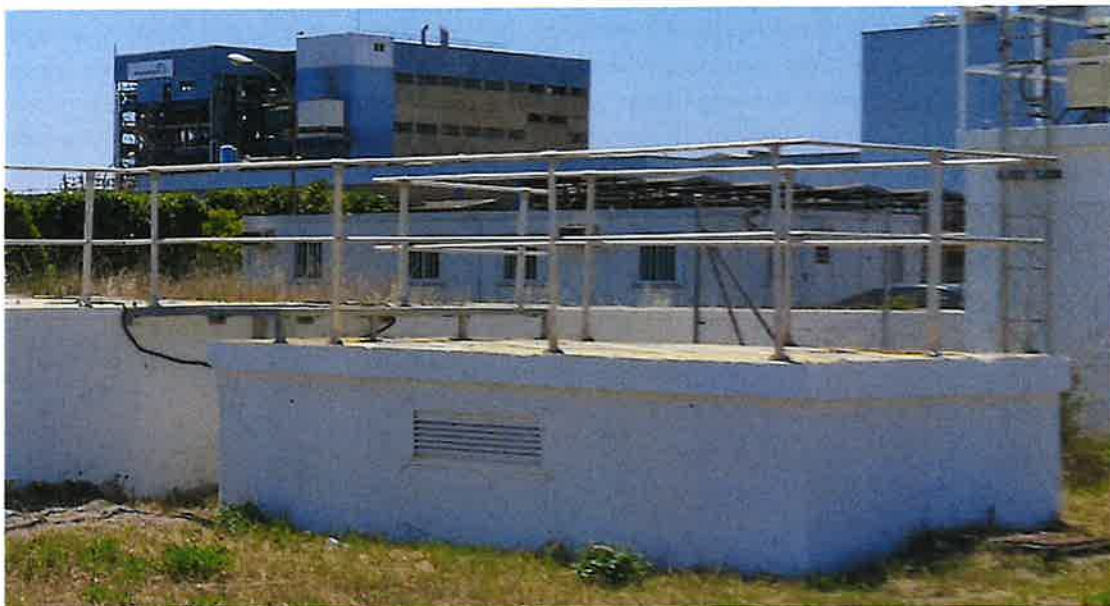
Fotografía nº 2: Arqueta de acometida
