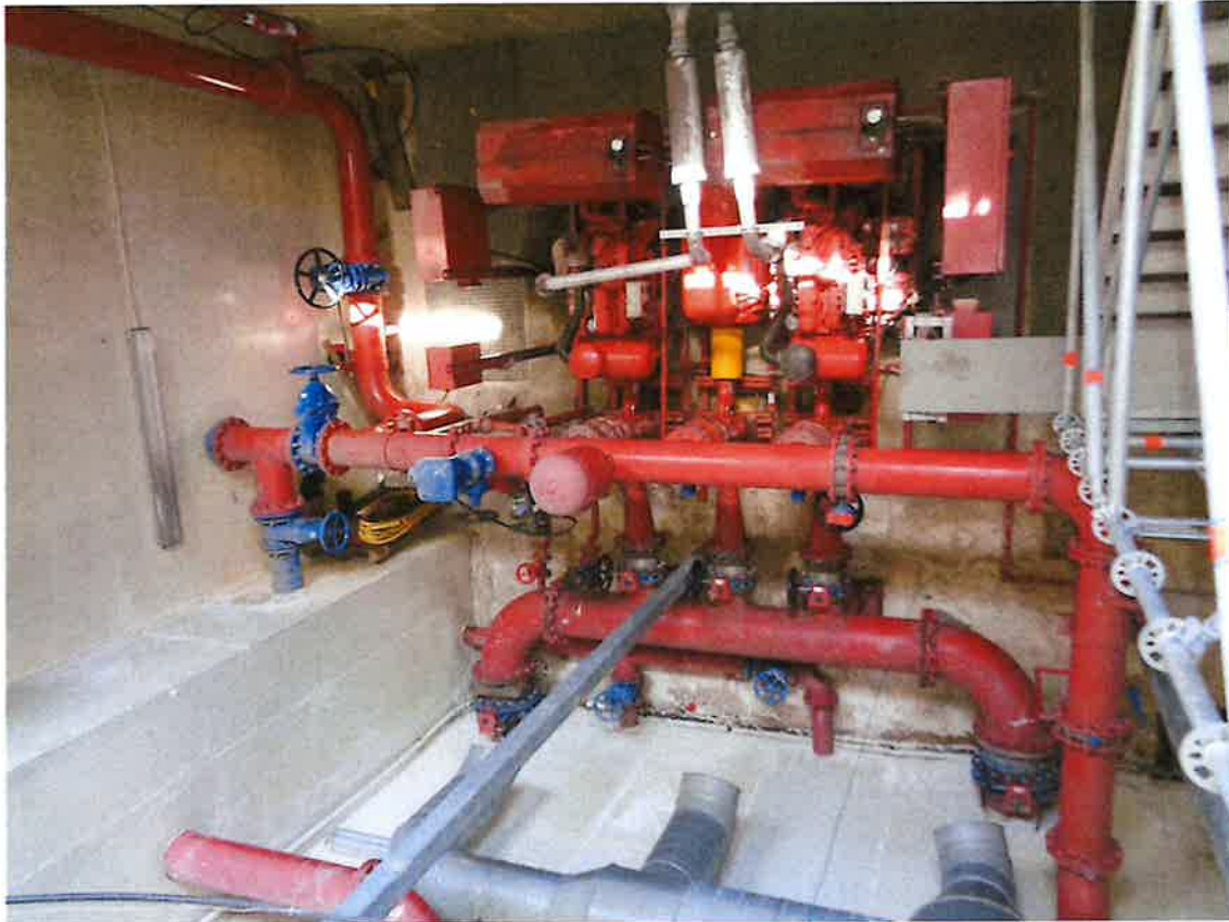
Fotografía nº 7: Grupo de bombeo contra incendios
