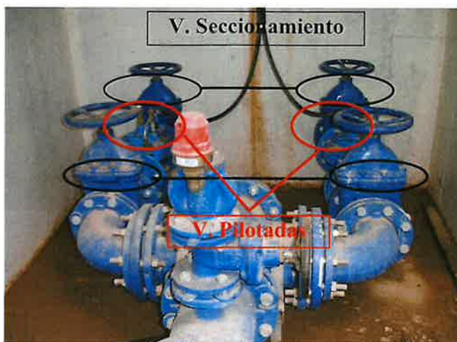
Fotografía nº 4: Válvulas arqueta de acometida
