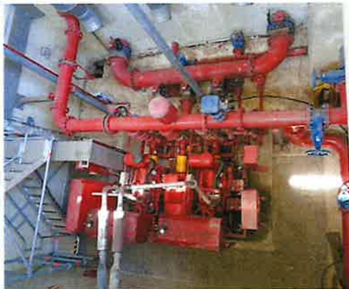
Fotografía nº 6: Sala de Bombeo
