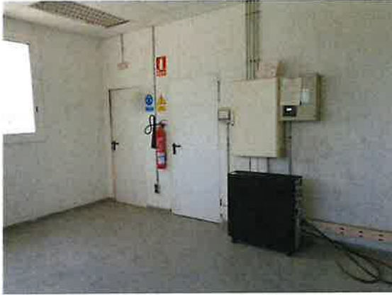
Fotografía nº 2: Sala de Control
