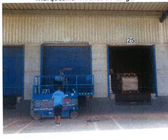
Patología Muelles de carga
