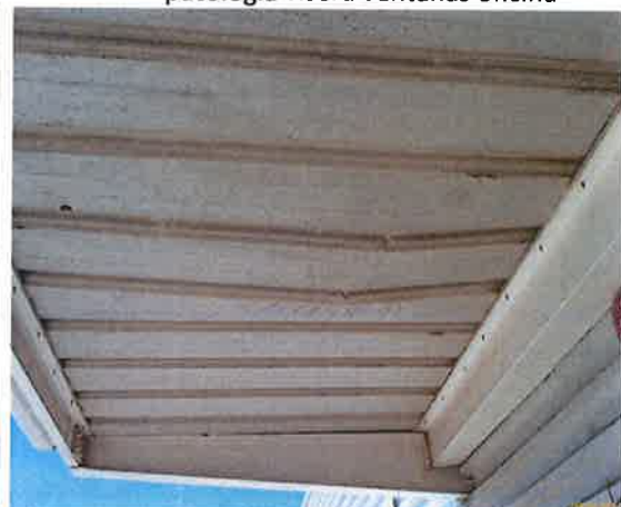
Detalle Patología marquesina entrada
