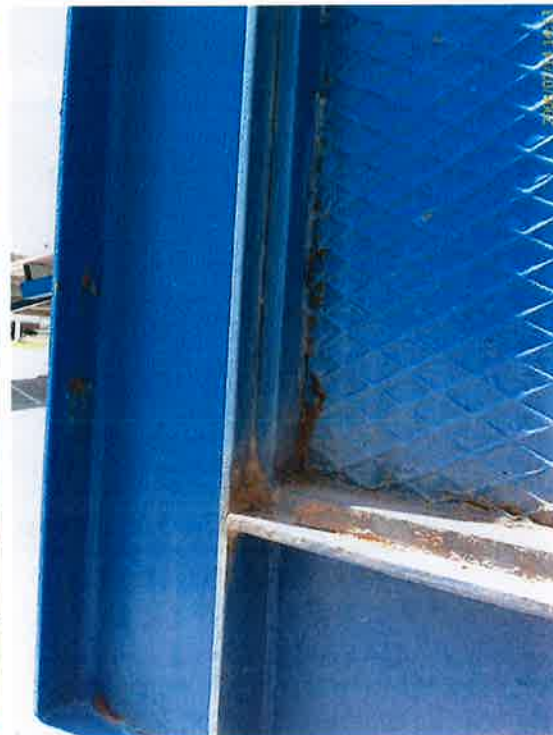
Detalle patología lucernario vertical
