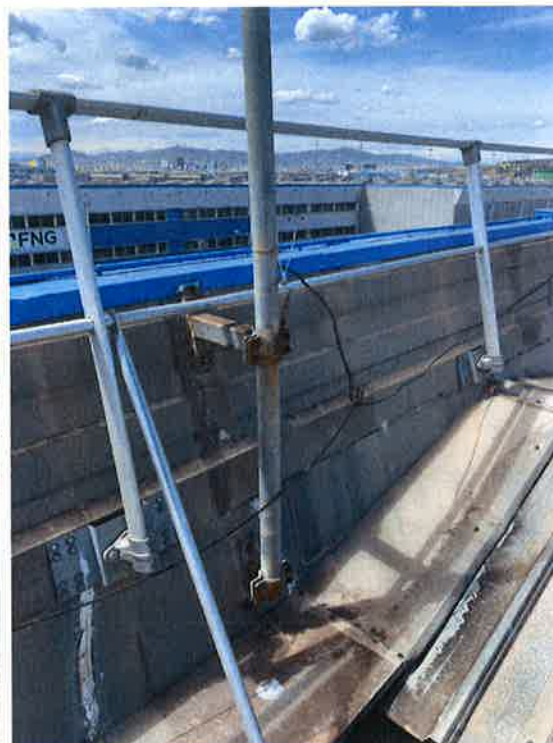
Vista sujeciones y tensor del hilo
