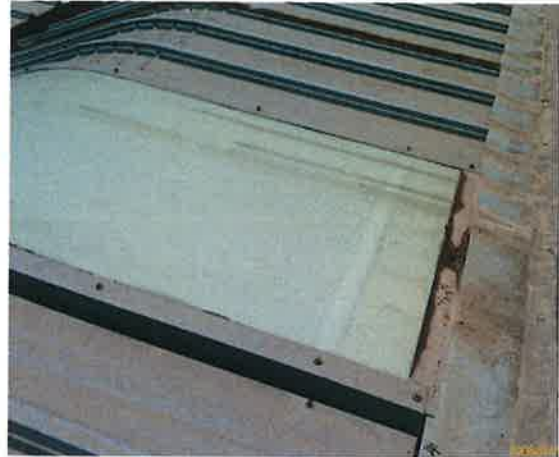
Detalle patología perfil perimetral lucernario
