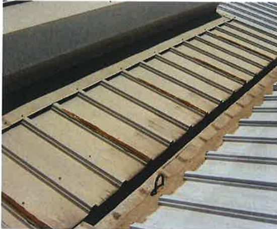
Detalle patología cubierta
