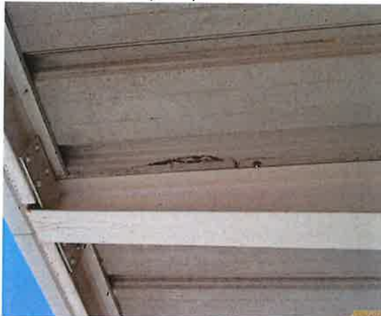
Detalle Patología marquesina entrada
