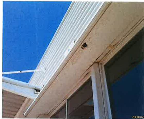
Detalle patología visera ventanas oficina
