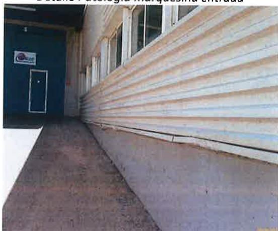
Detalle Golpes producidos en fachada de oficina
