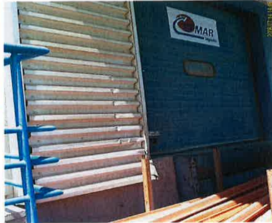
Detalle patología fachada almacén
