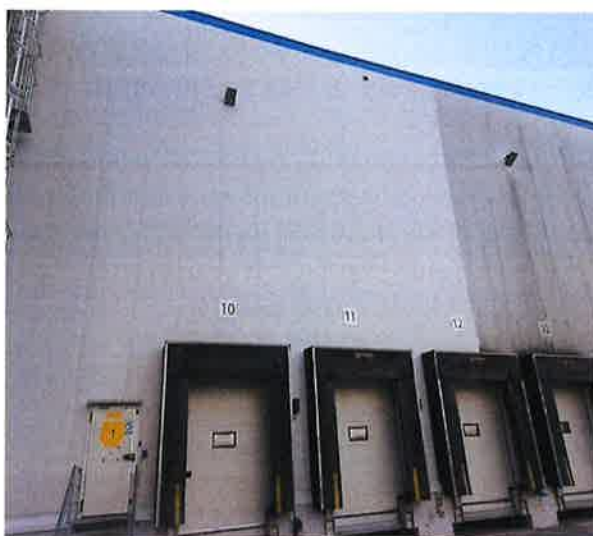
Vista del estado inicial y final de las fachadas afectadas por los residuos de combustible aéreo.
