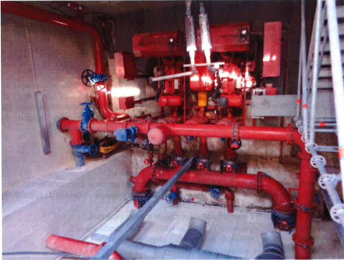
Fotografía nº 7: Grupo de bombeo contra incendios
