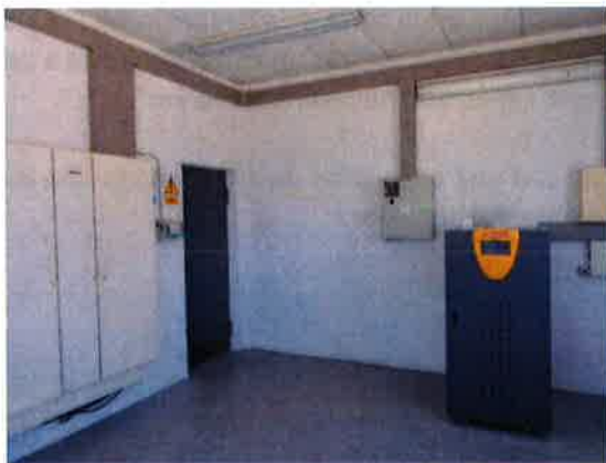
Fotografía nº 5: Sala de Control
