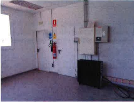
Fotografía nº 2: Sala de Control
