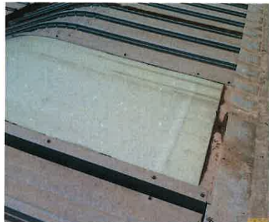
Detalle patología perfil perimetral lucernario
