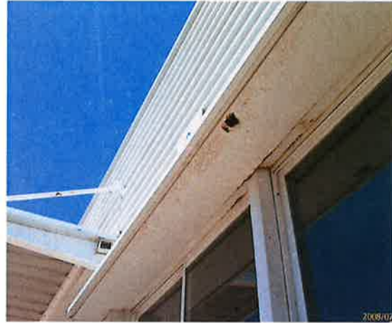
Detalle patología visera ventanas oficina
