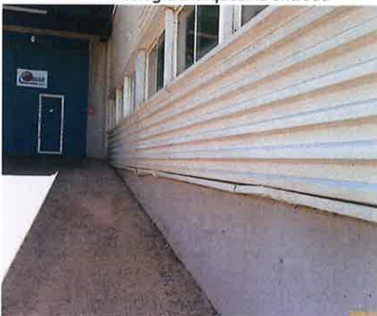
Detalle Golpes producidos en fachada de oficina
