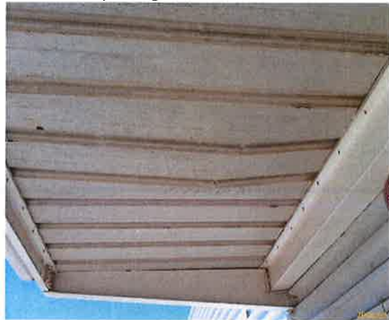
Detalle Patología marquesina entrada
