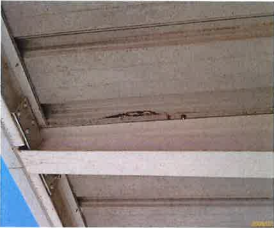
Detalle Patología marquesina entrada
