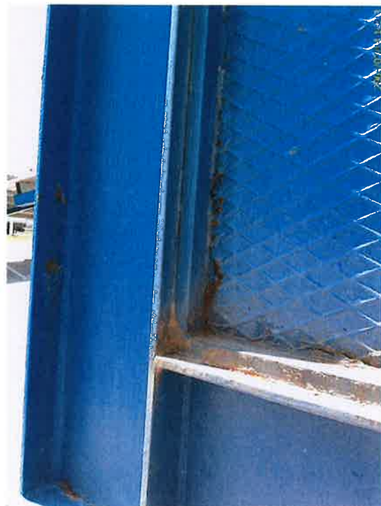
Detalle patología lucernario vertical
