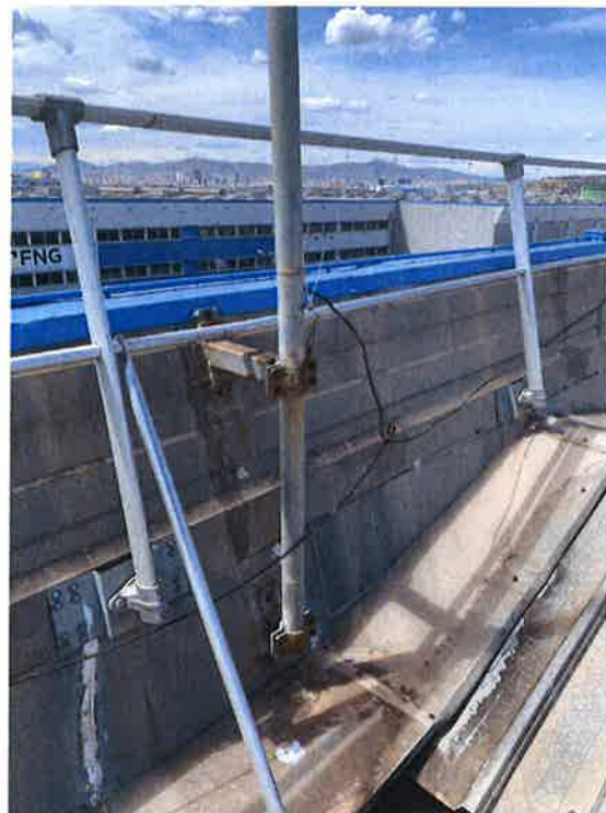
Vista sujeciones y tensor del hilo
