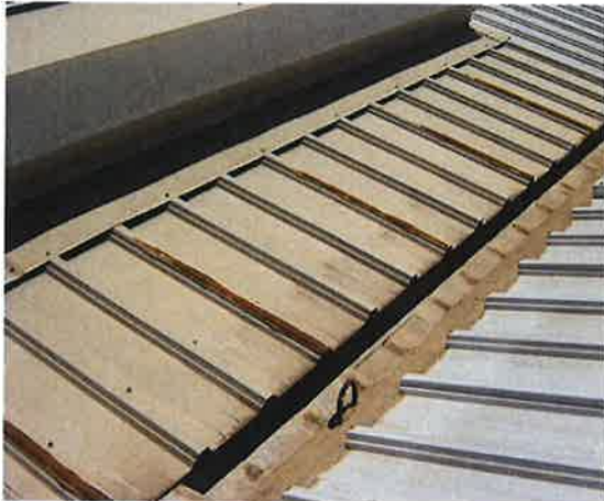
Detalle patología cubierta
