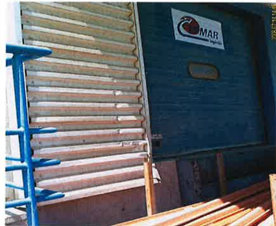
Detalle patología fachada almacén
